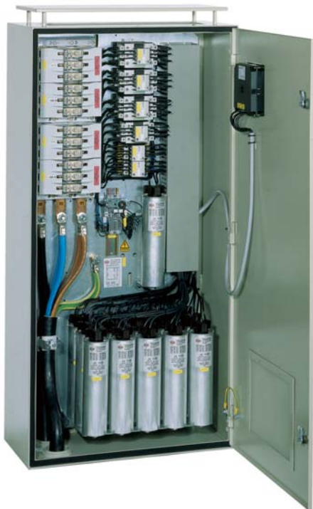
Bild 1. Die Wärmeeinstrahlung von NH-Sicherungen, Kondensatorschützen und Filterkreisdrosseln auf die Kondensatoren sollte so gering wie möglich gehalten werden
